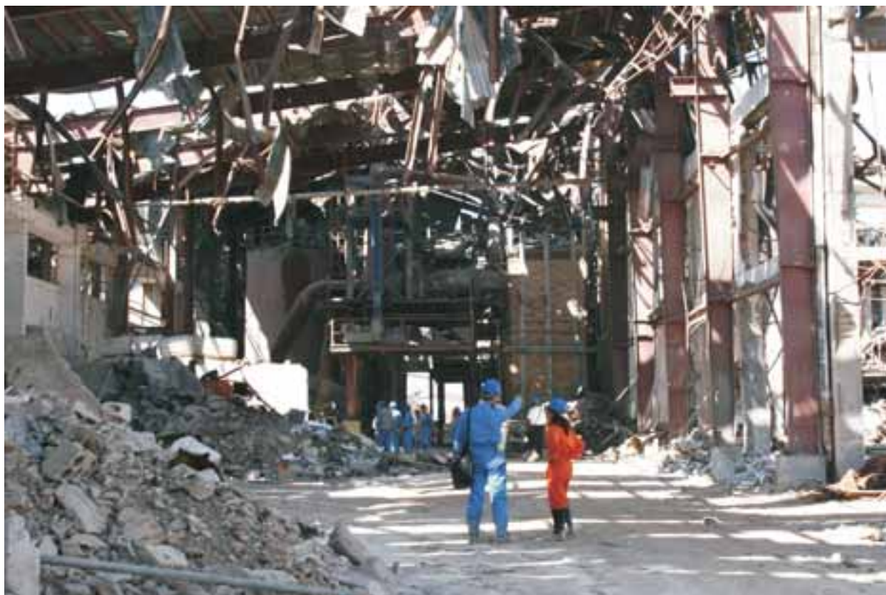
L'équipe du PNUE et des experts locaux procèdent à l'inspection d'une fabrique de verre endommagée à Zahlé
